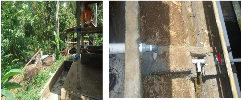
Gambar 7.5. Saluran urine sapi menuju instalasi pengolahan biourine
