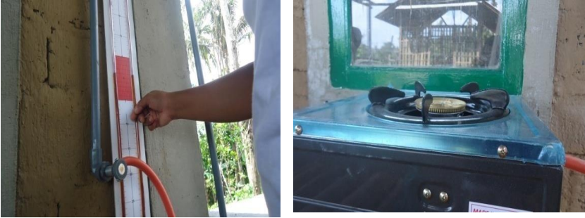
Gambar 7.6. Instalasi biogas sebagai kelengkapan kandang sapi system koloni
